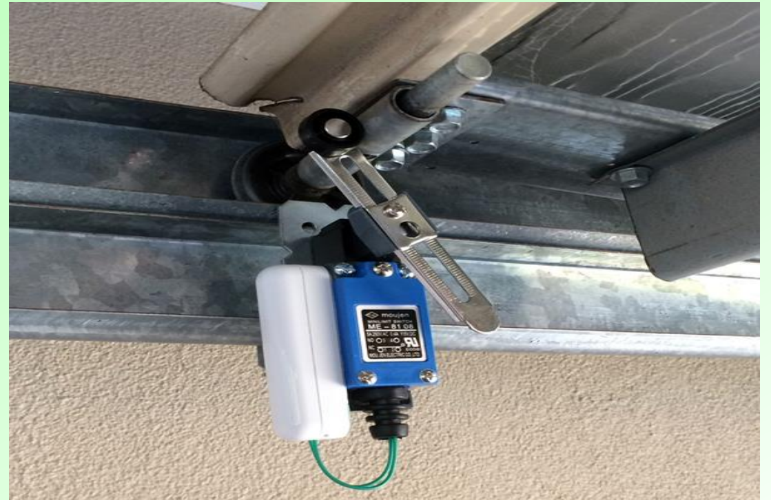
Công tắc hành trình lắp trên cầu tải hàng
